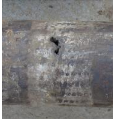
Rys. 7. Przykład zniszczenia elementu przewodu wiertniczego – wypłukanie rury płuczkowej
