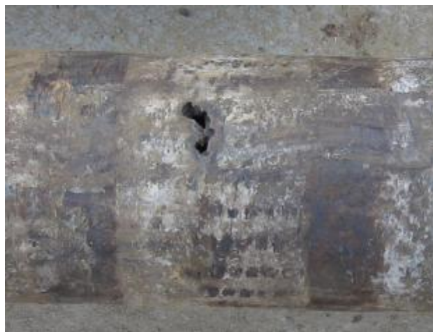
Rys. 16. Wyplukana rura płuczkowa w miejscu zgrzania ze zwornikiem
